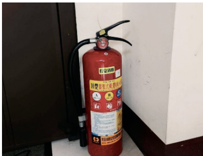
備有有效期限內滅火器
